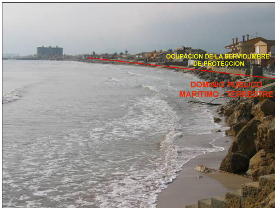
Figura 7. Viviendas con protección de escollera situadas en, la zona de protección sometida a la acción del mar y del ambiente marino.
